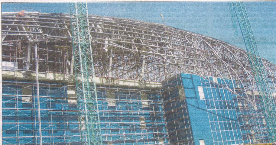
Astanan pyöräilystadionista tulee vajaat 100 metriä pitkä ja 50 metriä leveä velodrom. Tieto-Oskarın kehittämä järjestelmä valvoo sen rakenteita.
